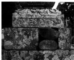
基壇東面 礫石経投入口 補修痕
