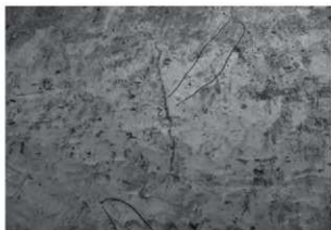
写真1. 第2-2層除去面 噴砂(東側)検出状況
