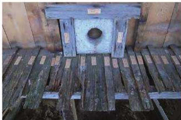
写 3-1-10 板底の破損 (北棟)
