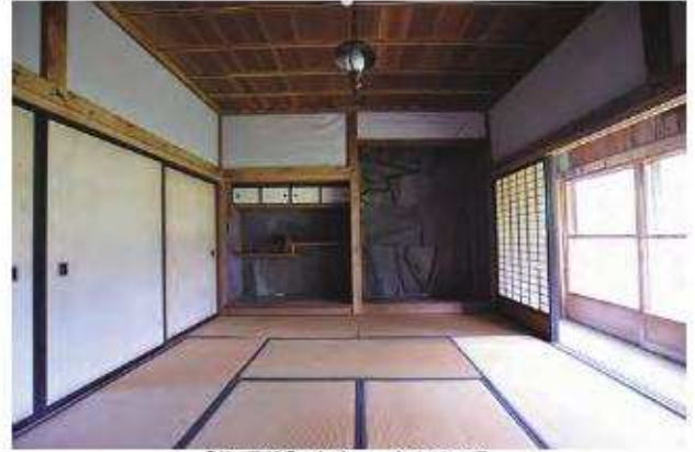
【修理前】客室5 南よりみる
