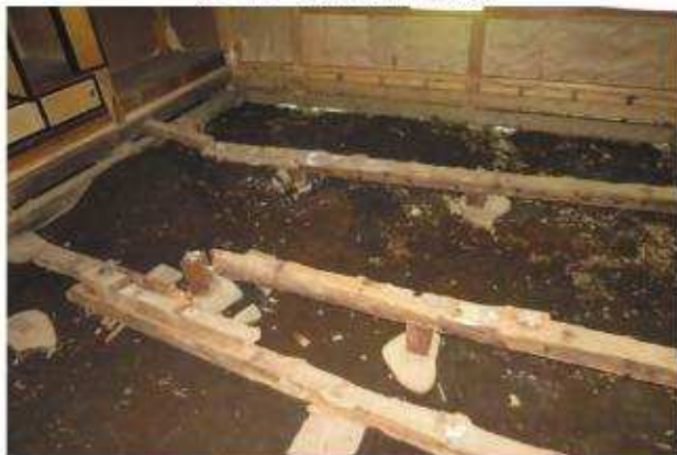
写 3-1-5 大引の腐朽折損 (仏間)
