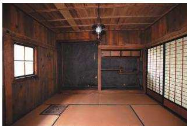
【修理前】客室7 南よりみる
