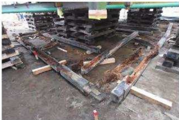
写 3-1-6 土台 (裏面) の腐朽 (北棟)
