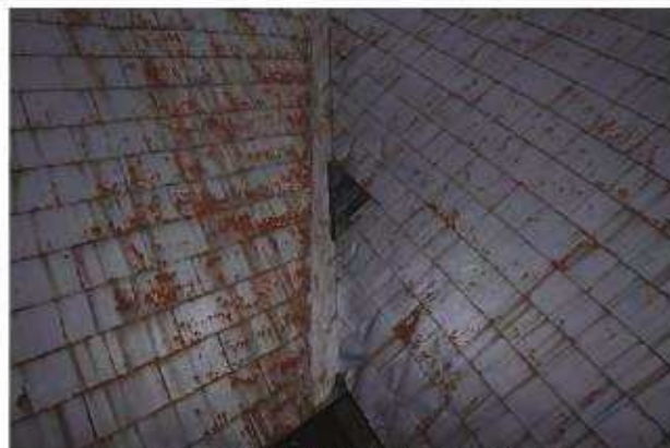
写 3-1-11 屋根鉄板谷部の破損 (中央棟と南棟)
