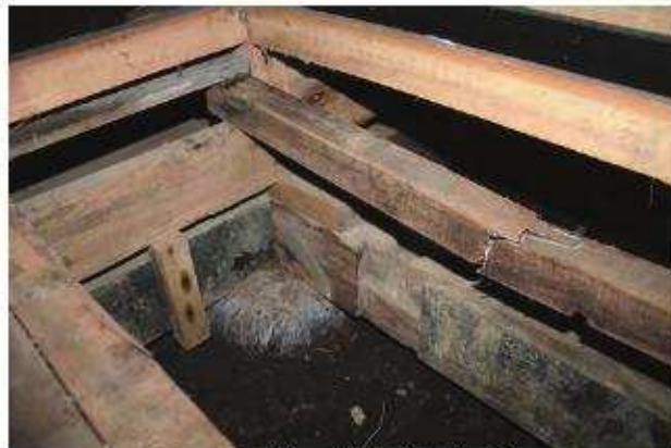
写 3-1-4 根太の腐朽折損 (茶の間)
