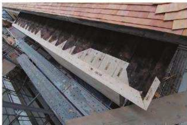
野地板籍い状況「北棟」二階東側底 北東よりみる
