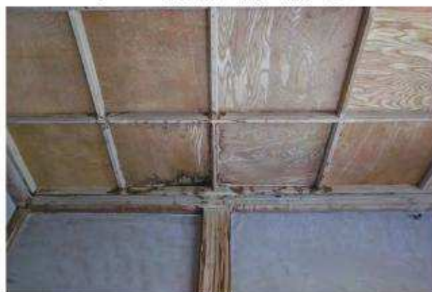
写 3-1-15 雨漏りによる天井面汚損 (事務室)
