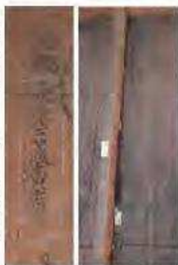
写3-5-7 天井板の印字 左：事務所、右：廊下
