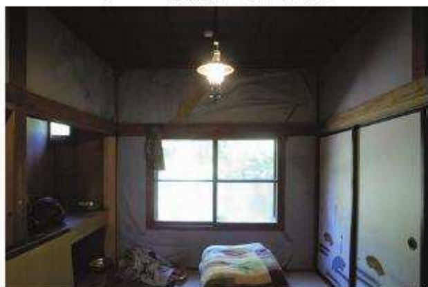
写 3-1-14 雨漏りによる壁面汚損 (客室 3)
