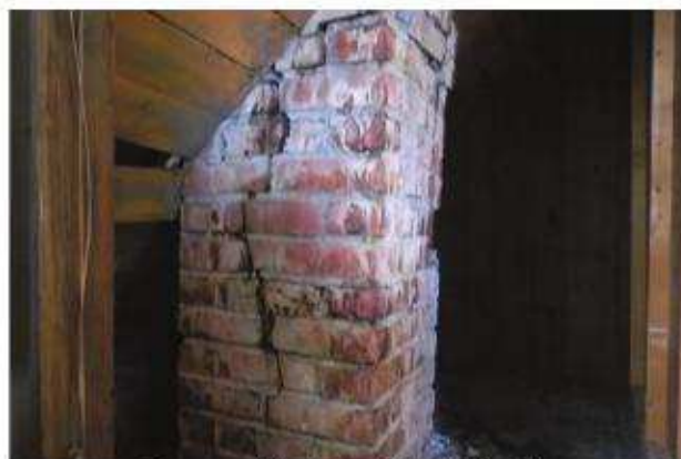
写 3-1-13 煉瓦煙突の割損 (南棟二階)
