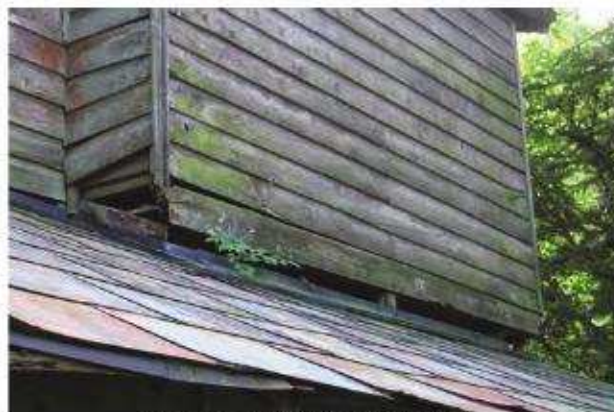
写 3-1-9 北棟下見板の破損 (北棟)
