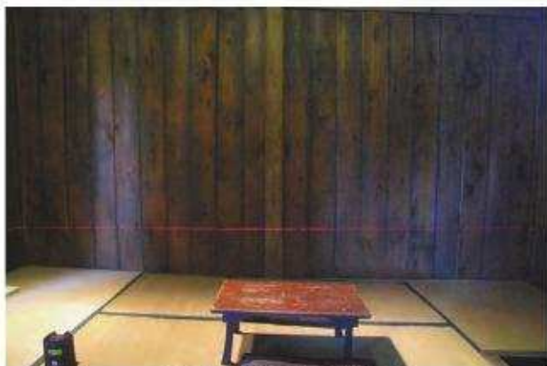
写 3-1-1 床の不陸 (客室 6)
