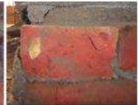
写 3-5-51 割損面に露出した砂岩片
