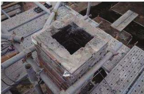
写 3-5-49 コンクリート充填範囲撤去状況 煉瓦半枚積みで内部に円筒を入れず中空の状態である。
