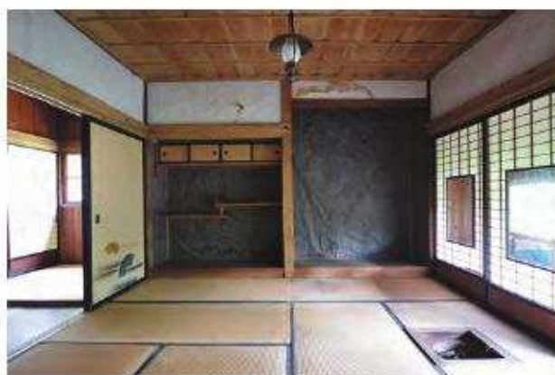
【修理前】客室8 南よりみる
