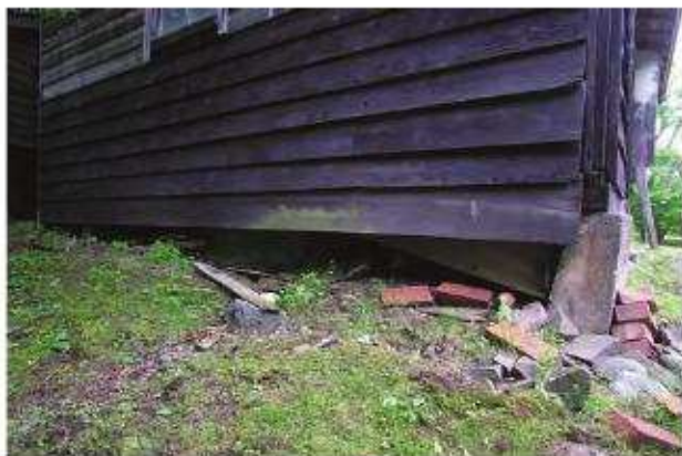
写 3-1-3 基礎の倒れ (南棟)
