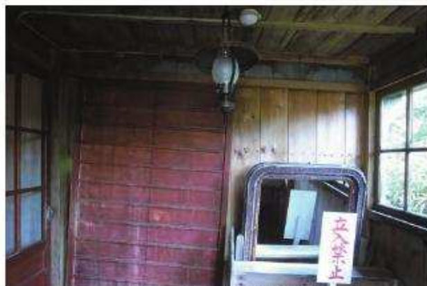
写 3-1-2 床の不陸 (北棟便所)
