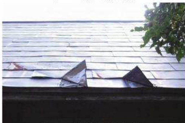
写 3-1-12 屋根鉄板の破損 (中央棟)
