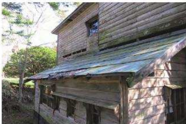
写 3-1-8 軒先の破損 (北棟便所)
