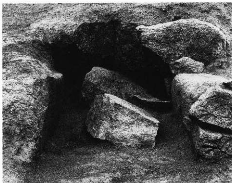
2. 巨勢山323号墳 羨道部天井石陥落状況（南から）
