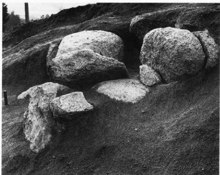
1. 巨勢山323号墳 羨道部天井石陥落状況（東から）
