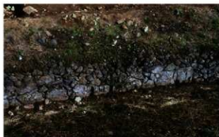
A区西面を区画する石垣(西側から撮影す) 下段の石の積み方が上段とは異なっている
