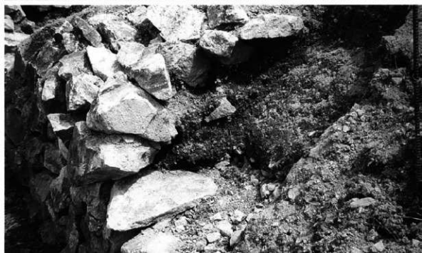
後円部北側裾石垣 丁張りNo.17付近断面 流失した土が裏込に堆積
