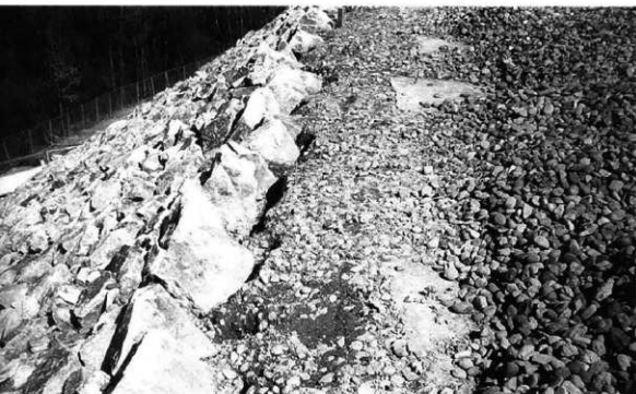
後円部北側上段テラス 丁張りNo17～18の間 石材がずり落ちている
