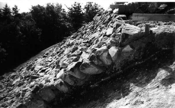
後円部北側丁張りNo17断面 葬石表面から30cmほどま での下地土は緩んでいる
