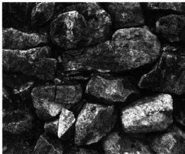
後円部北側墳丘斜面 葦石材が風化や変動によって破損している
