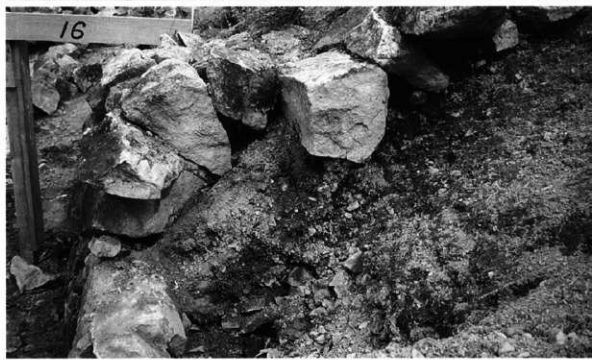
後円部北側裾石垣 丁張りNo.16付近断面 大きな隙間ができています
