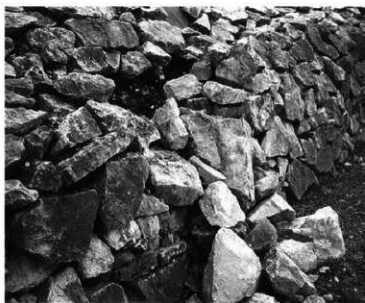
後円部北側据石垣 平成10年3月下旬、据石垣崩落発生
