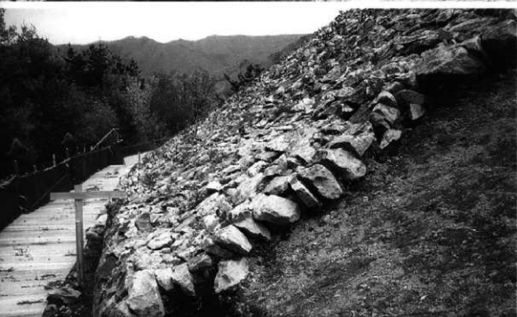
後円部北側丁張りNo18～19の間 葬石下地土が流失し、墳丘斜面 は凹凸が激しい
