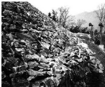
後円部北側 丁張りNo.16～17付近 勾配変換点上部の葦石が大きく陥没し、据石垣が崩落した
