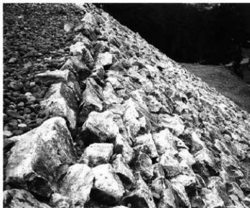
後円部北側上段テラス 丁張りNo.16～17付近 葦石最上部の石材が落ち込み、葦石面が階段状に変動している
