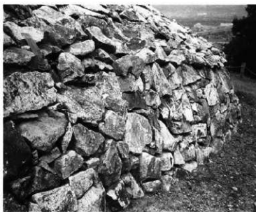
後円部背面 丁張りNo.13～14付近 勾配変換点で連続して石材がせり出している
