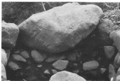
3. 天井石の崩落状態（女室）
