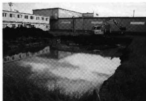
I-1 湧水による冠水
