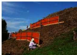
調査前に設置した転落防止柵
