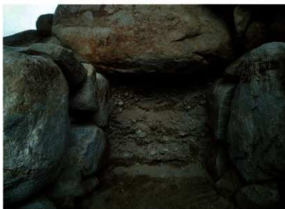
(3) 灌漑水路出口 土砂堆積状況
