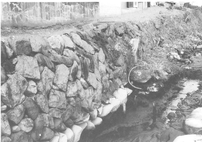
西面城内側石垣の破損状況
