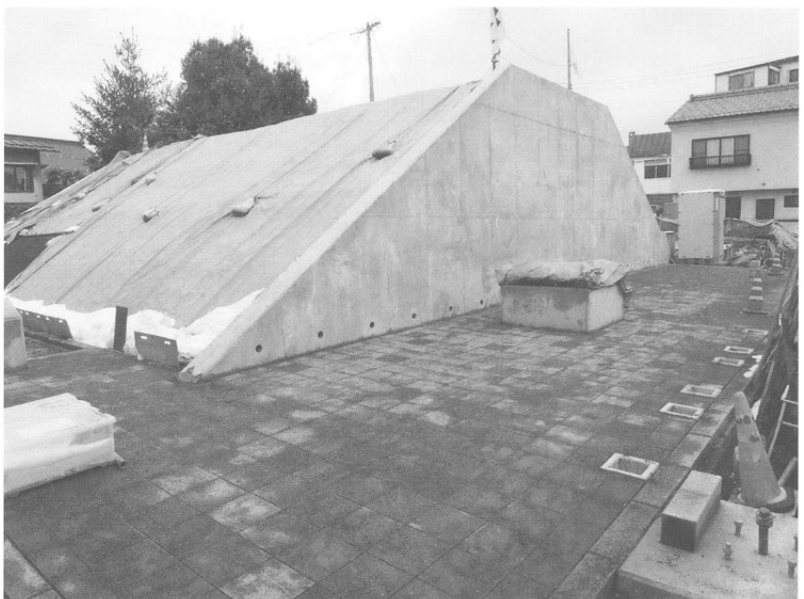
広場南西隅から南側擁壁 広場は石敷きが終わりベンチ基礎 や全体説明板の躯体が出来る
