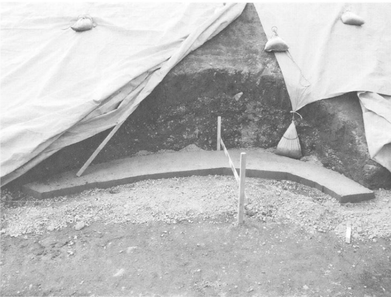
東法面擁壁の基礎 池状遺構の挟り込み部分に設けた 擁壁基礎部分
