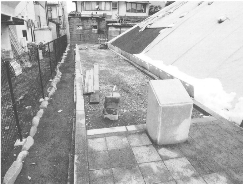
土塁西側 東面同様カラー舗装の路床が整えられ、 手前に尖状杭列説明板躯体が据わる
