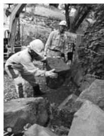
崩落石垣石材保護状況
