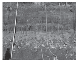
北5工区P1橋脚土層堆積状況
