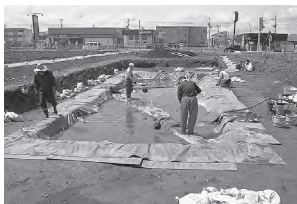
トレンチ1 排水状況(北から)
