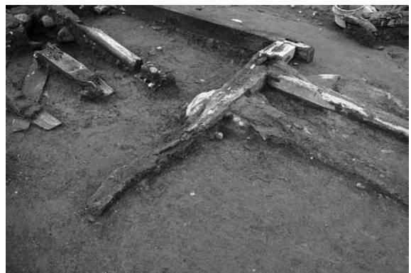
1号建物4号床・床の間付近の土台腐蝕の様子 南東→
