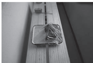
除去剤が蒸発するのを防ぐためラップフィルムを用いて密閉する
