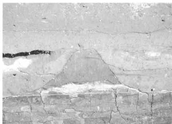
北壁洪水浸食状況、南から
