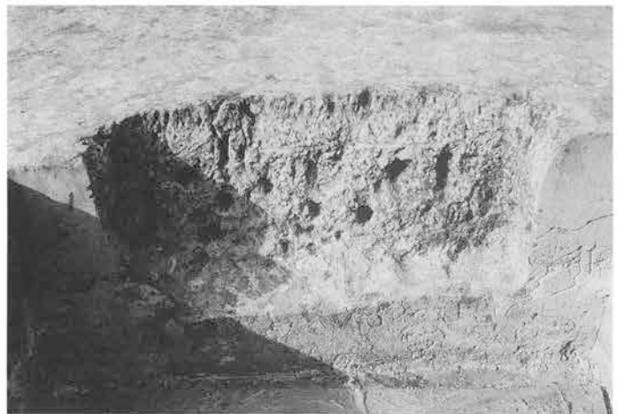
d. 同左・半割断面の状況
