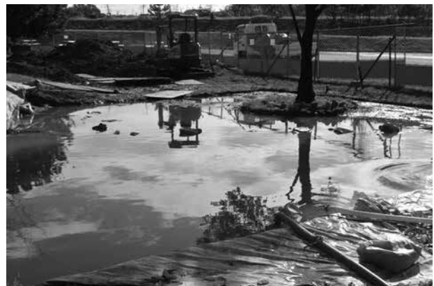
39 8トレンチ冠水状況
