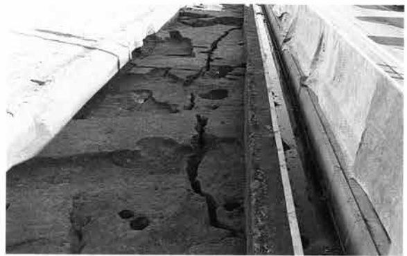
2. 地割れ：k (2区・西より)
