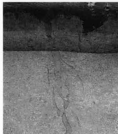
8. 地割れ (噴砂): f④ (2区・南より)
