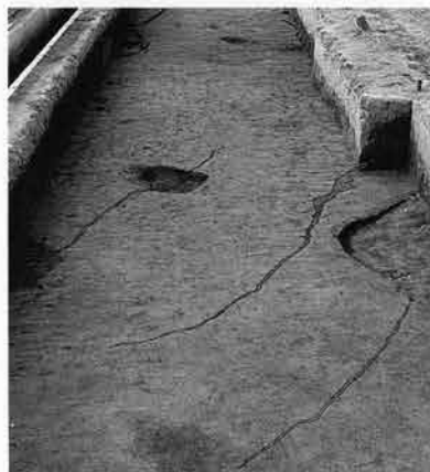
2. 地割れ (噴砂): h・i・j (2区・東より)
