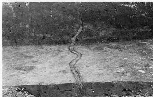
4. 地割れ (噴砂): g② (2区・南より)
