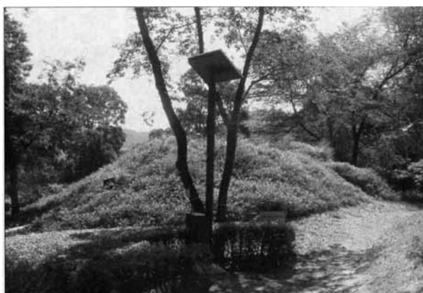
ソーラー設置状況
