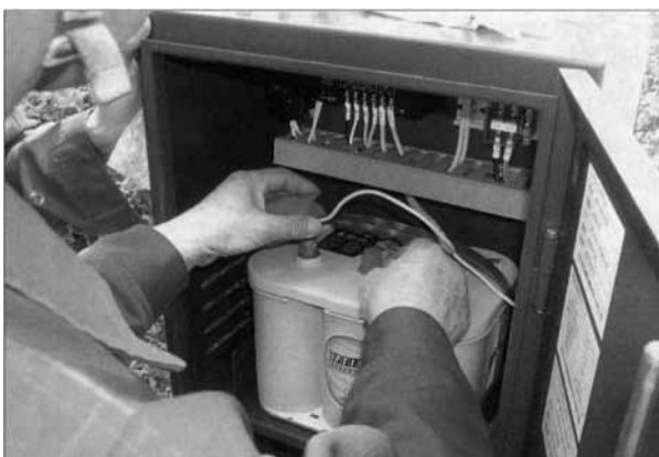
バッテリーの配管状況
