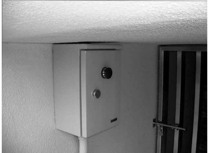
スイッチボックス取付状況
