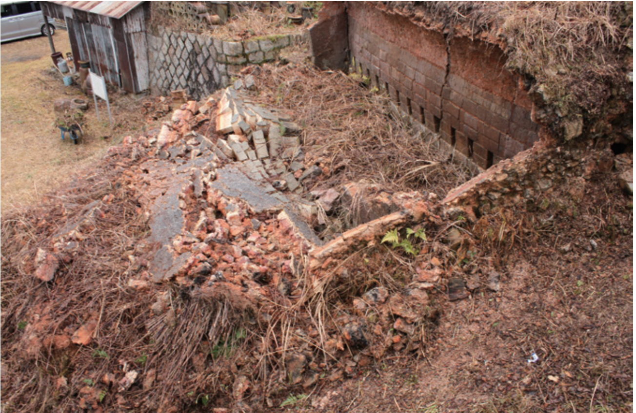
写真 40 : 22-10 次 崩落状況 (西から)
