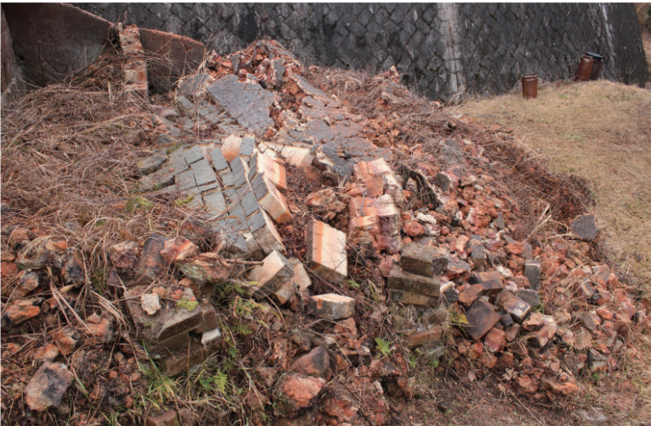
写真 41 : 22-10 次 崩落状況 (東から)
