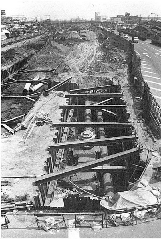
工業用水管接続部
