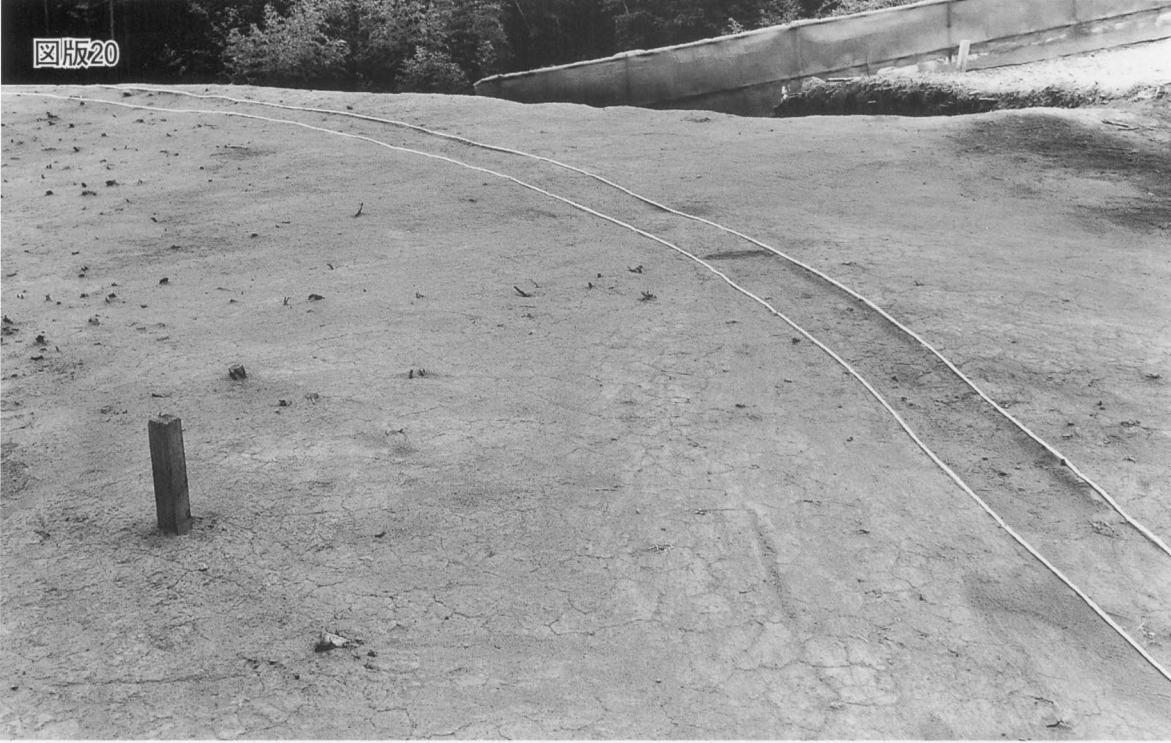
SX-8 地割線 (盛土中)
