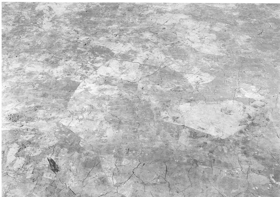
3区地震による地割れの状況
