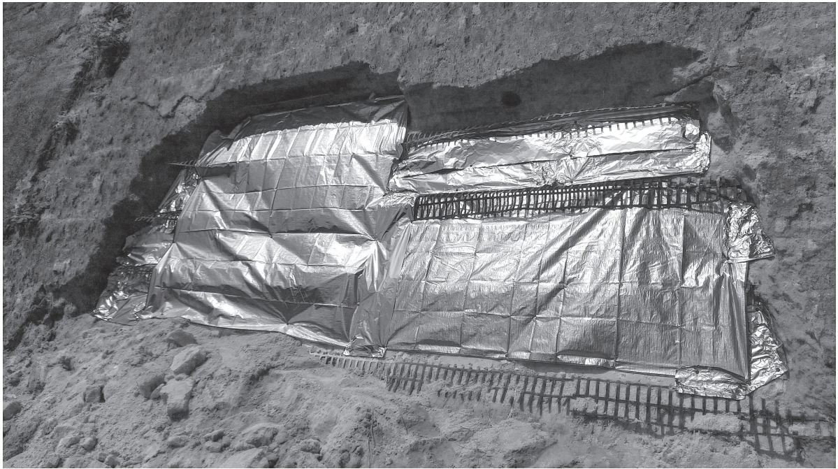
第24図版 西門東側版築土壘損壊状況（南から）
