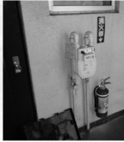
消火器の設置例
