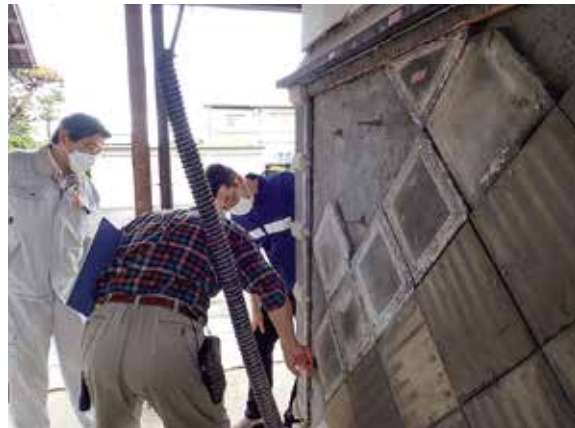
(図61) 被災歴史的建造物の被害状況調査
