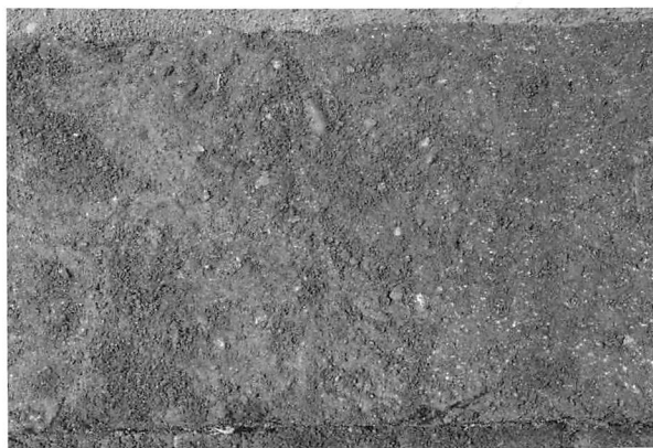
4. VFCEB-03検出 NE→
