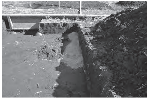
図3 土壌水分センサー，温度センサー設置状況② (2012年11月14日)
