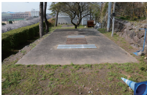
浄化槽（本丸西）
