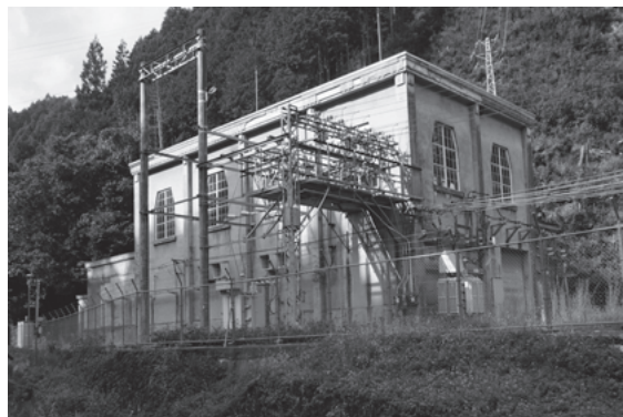
図11 細川変電所 (No. 229)
