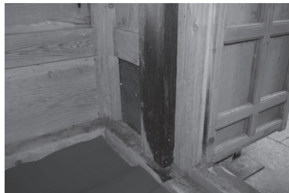
図 613 奥之院密厳堂正面内側焼損痕跡、隅柱埋木
