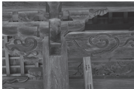
図 247 金剛峯寺山門虹梁形頭貫・木鼻の焼損
