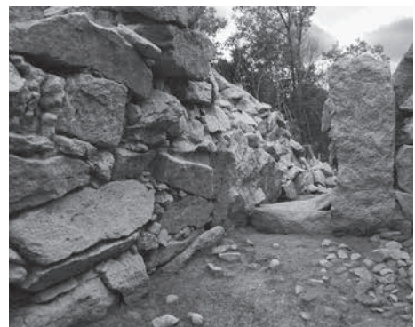
写真 25 桑山 1 号墳側壁崩落状況 〈右側壁玄門付近〉(北から)
