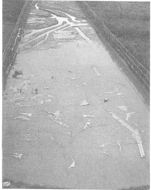
写真4 A地区水没（北から）
