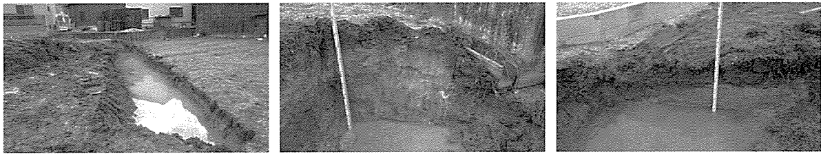
第79図版 ①の調査状況 左：西側の擁壁掘削（北から） 中：南壁 右：北壁
