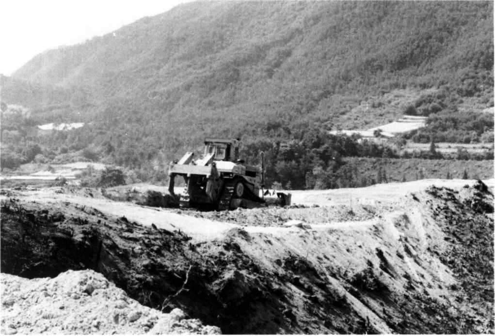
1. 調査後破壊される8号墳
