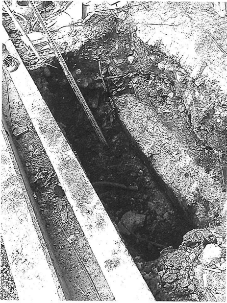
写真4 第6トレンチの掘削終了状況。南から北を撮影。現地表面下約1.5mまで掘削したが、盛土層が続いた。河道跡の凹地を埋めたものと考えられる。
