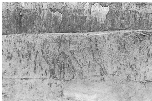
2、3Atr.東壁断面1546流路内噴砂（西から）
