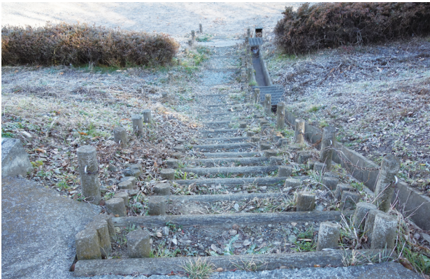
整備前の階段。砂利が流れ出てしまっています。
