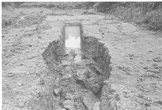
F区全景 (湧水により崩落するトレンチ)
