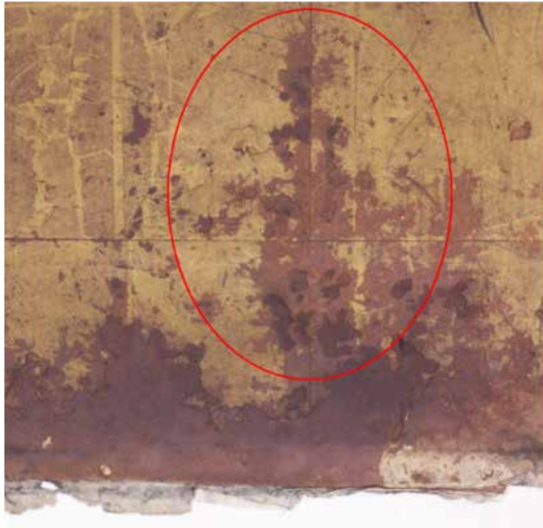
写23 修理前 東側 金箔地の剥落
