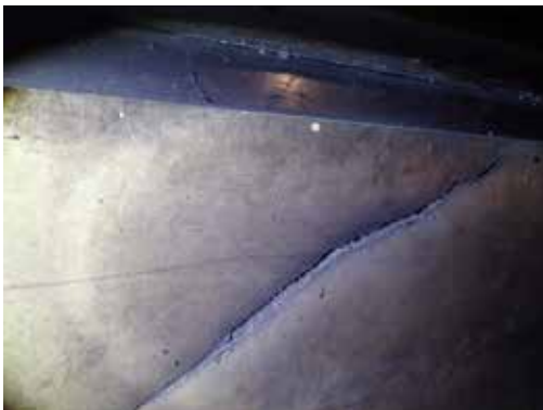
図12 取り外し前亀裂
