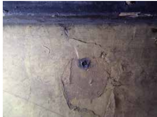
図11 釘錆による腐食
