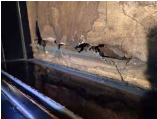
図10 取り外し前亀裂
