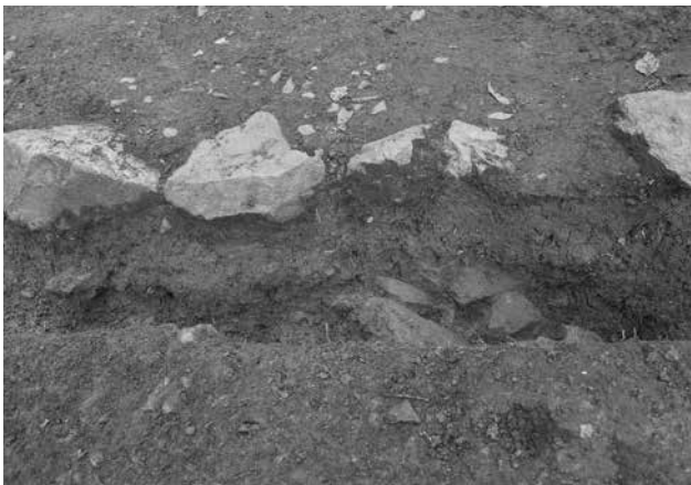
3. 九丁石付近参道横断トレンチ断面②（図15A-A'断面南西から）
