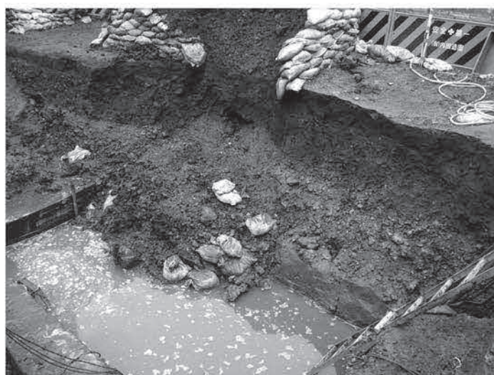
▲ 4. 崩落状況 (南東から)
