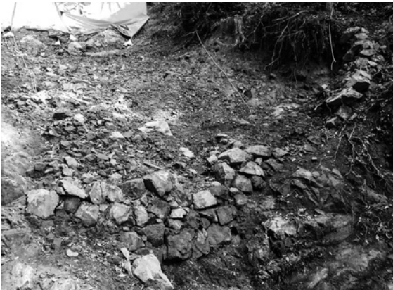
写真33 雌池背後の石垣被害状況 北から
