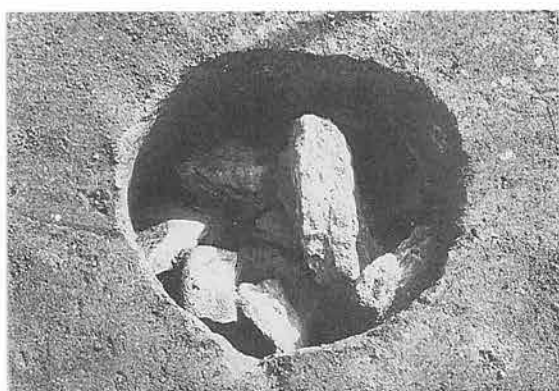
煙出し部 隙検出
