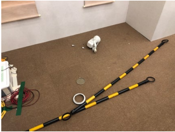
図2-24 スポットライトの破損・落下
