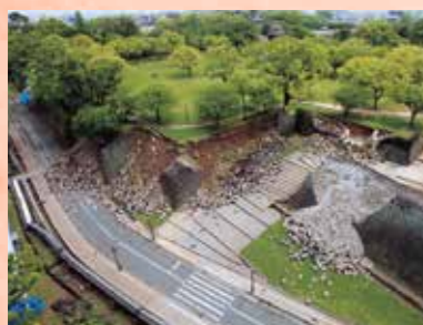
被災状況 H28(2016)4月
