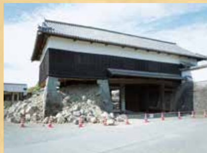
被災状況 H28(2016)4月
