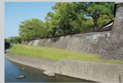
被災状況 H28(2016) 4月
