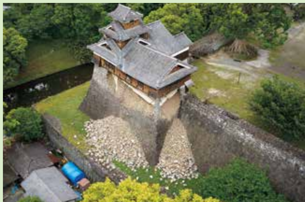
被災状況 H28(2016) 4月
