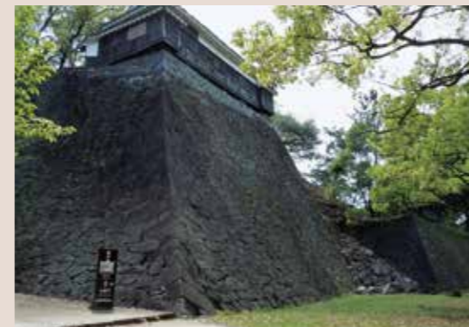
被災状況 H28(2016) 4月
