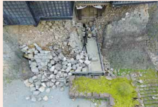
小天守入口部被災状況（平成28年5月11日）
