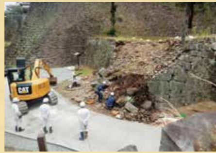
二様の石垣南側石垣崩落石材回収 奥は二様の石垣（令和元年6月8日）
