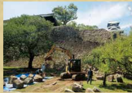
地蔵門石垣崩落石材回収 奥は大天守（令和元年7月12日）
