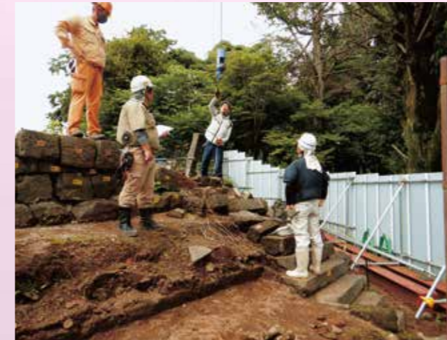
崩落石材回収状況（令和3年7月12日）
